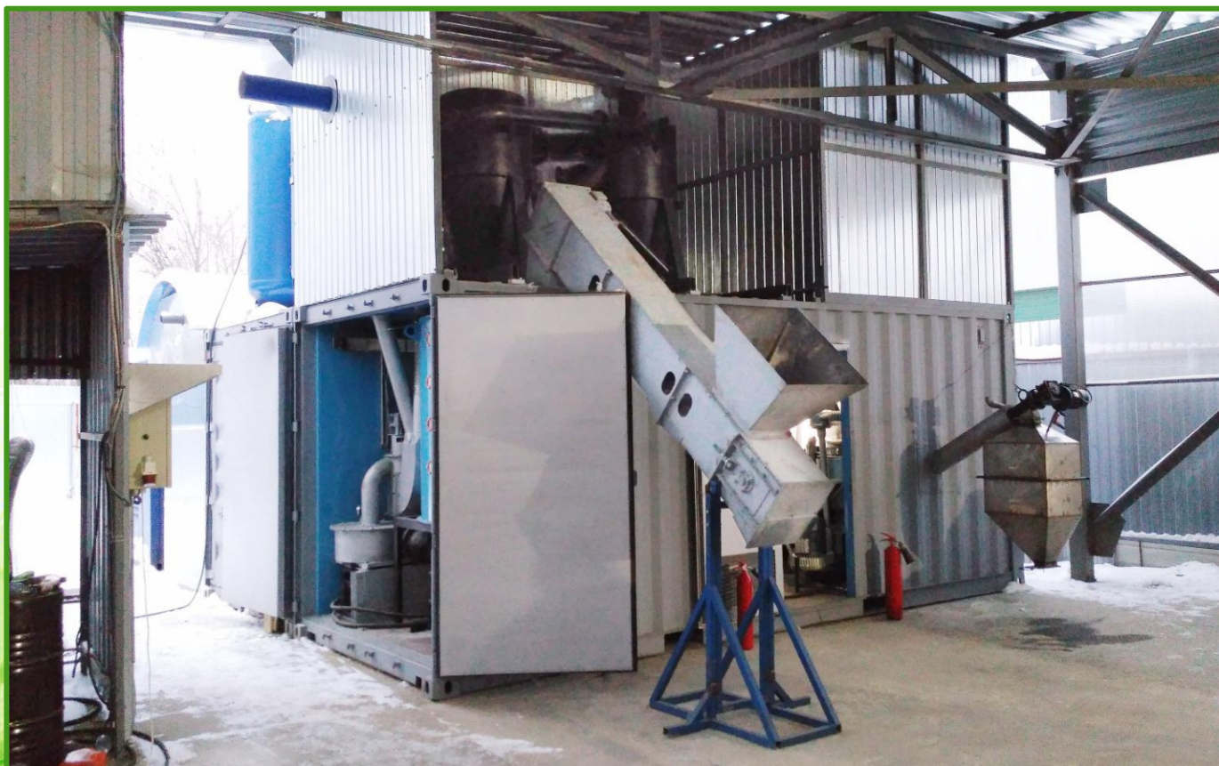
Общий вид установки
