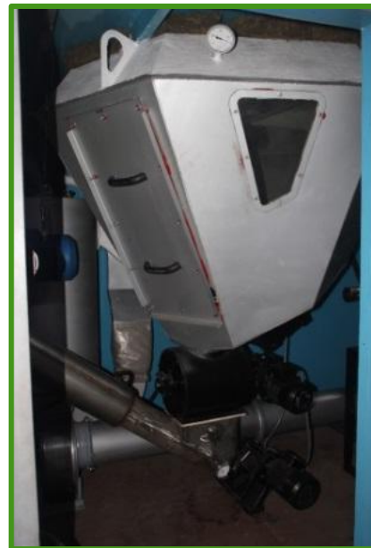
Бункер хранения подготовленного сырья
